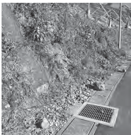
台風後に太陽光発電設備周辺で見られた市道への落石
